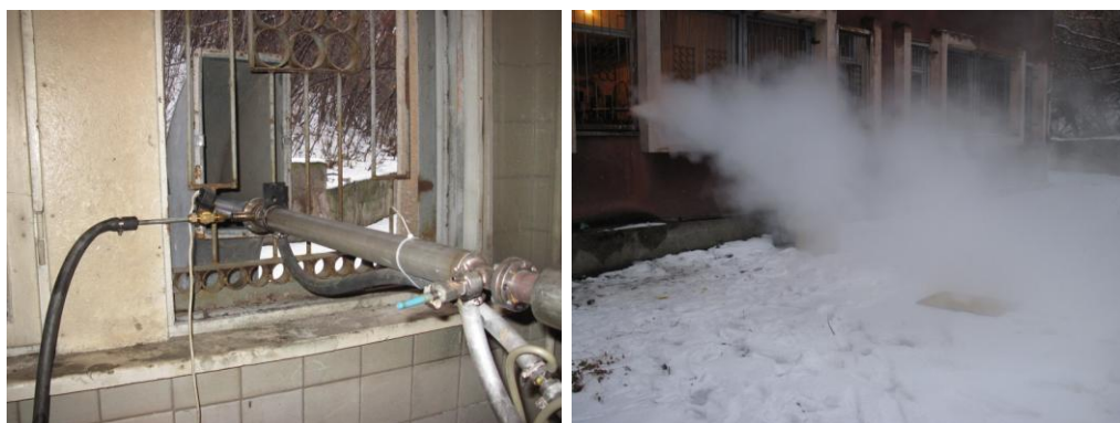
Рис. 3. Загальний вид установки пожежогасіння
