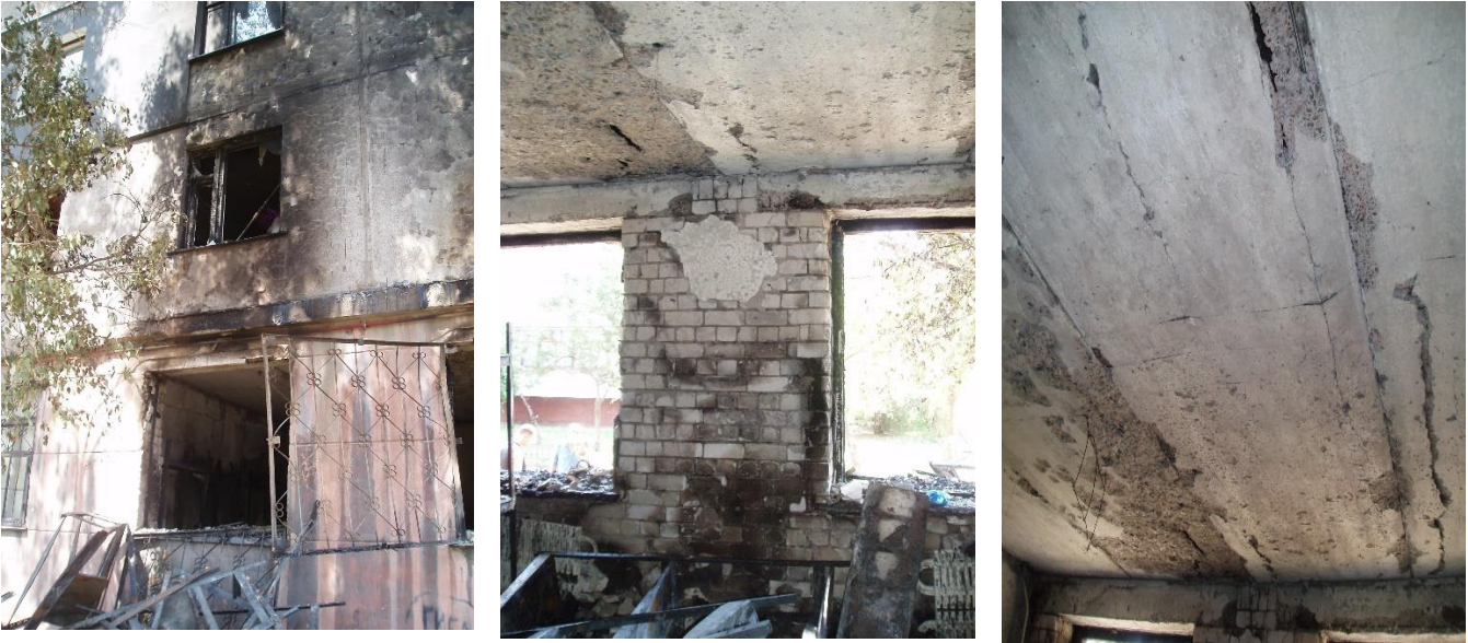
Рис. 23 Натурні обстеження будівельних конструкцій після пожежі в магазині промислових товарів в м. Алчевську
