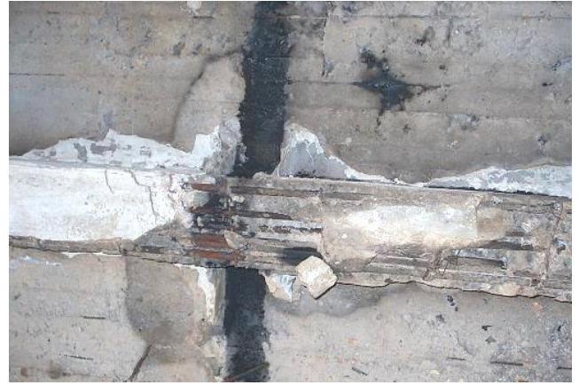
Рис. 2 Порушення захисного шару бетону з оголенням робочої арматури
