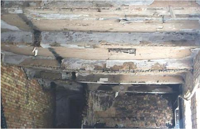
Рис. 1 Вигляд тріщин у місцях обпирання залізобетонних балок на стіну
