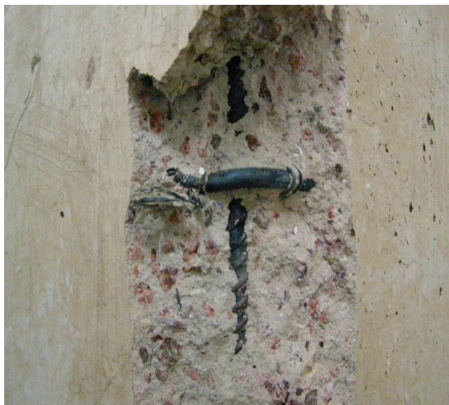
Рис. 12 Руйнування захисного шару бетону колони після випробувань
