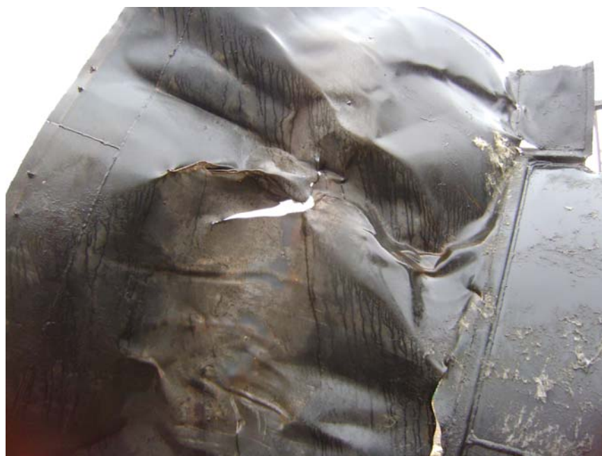
Рис. 2. Следы деформации металлического корпуса котла IGNIS 500 в результате действия динамических нагрузок изнутри
