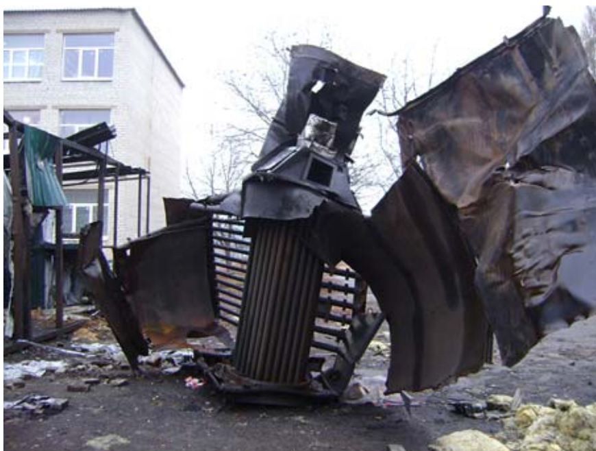
Рис. 1. Общий вид котла IGNIS-500 со следами разрушения металлического теплообменника и корпуса
