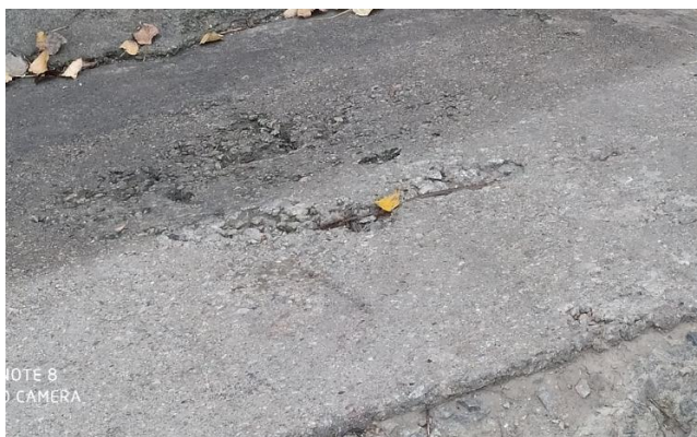
Рис. 1. Відшарування захисного шару бетону з оголенням арматури на плитах магістрального каналу
