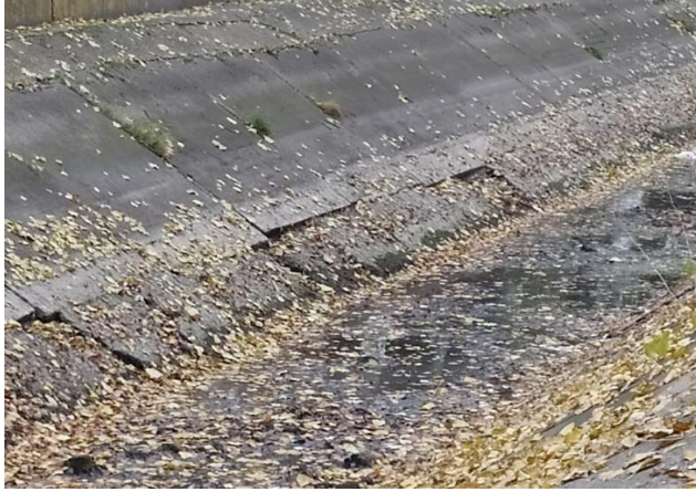
Рис. 2. Тріщини в конструкціях та порушення суцільності конструкцій споруди
