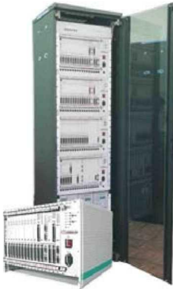
Рис. 16.2 – Зовнішній вигляд комутаційного обладнання СОДЗ «Протон-ССС»
