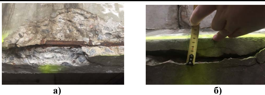
Рис. 1. Ригель на позн. +11,200 (4 поверх), по осі «1» в осях «Д–Е»: а) корозія робочої арматури, відшарування захисного шару бетону внаслідок замокання; б) горизонтальні тріщини шириною розкриття w_k=30 мм по нижній поверхні, корозія робочої арматури.
