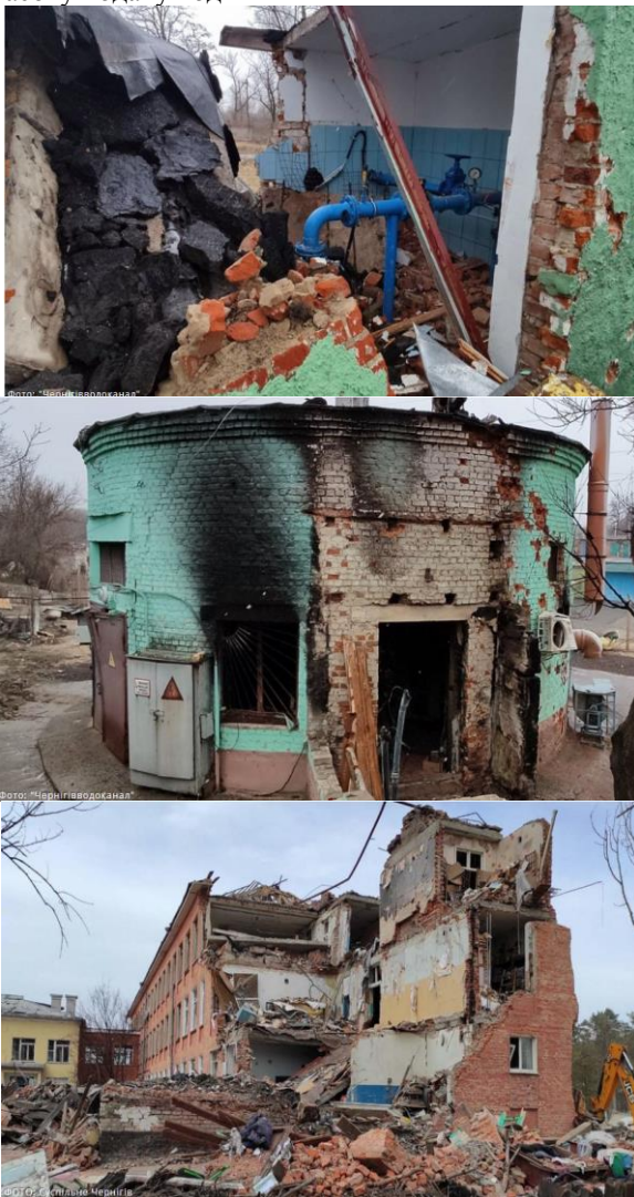
Рис. 10. Наслідки обстрілу об'єкту КП «Чернігівводоканал» [18, 19] мережі селищ [20]
