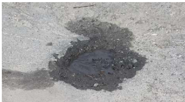
Рис.1.Фрагмент поверхні асфальтобетону від враження ОФС
