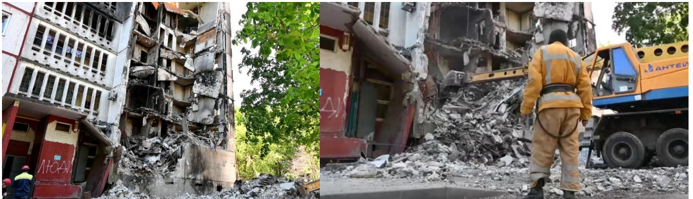
Рисунок 1 – Пошкоджена будівля на Північній Салтівці.
