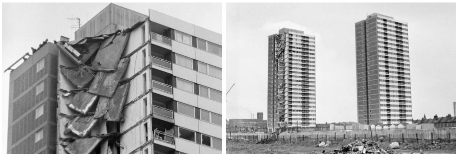
Фото. 1 16 травня 1968 рік, Лондон. Наслідки ефекту прогресуючого обвалення конструкцій житлового будинку після вибуху побутового газу в одній із квартир.
