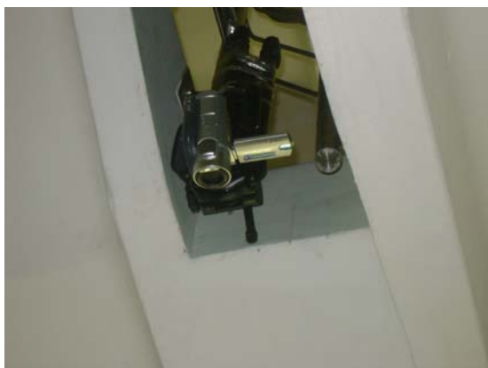
Рис. 1 – Место установки видеокамеры при проведении натуральных наблюдений за слиянием людских потоков в лестничной клетке
