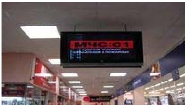
Рис. 2 – Пункт информирования и оповещения населения в зданиях с массовым пребыванием людей (ПИОН)
