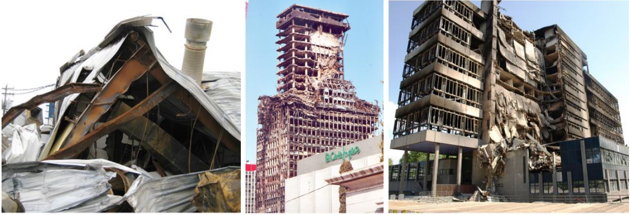
Рис. 1. Стан сталевих конструкцій будівель після пожежі
