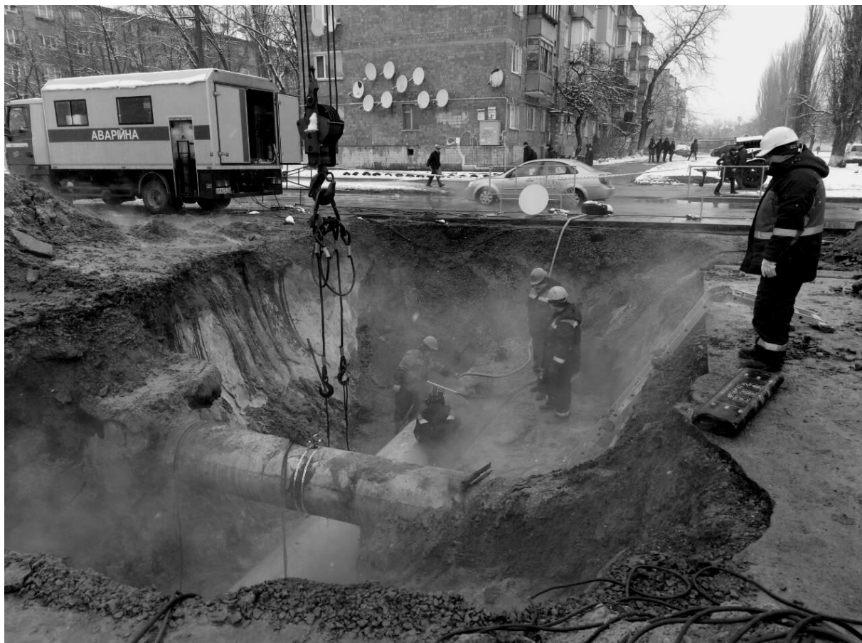
Рисунок 1.22 – Внаслідок пориву мережі 24 грудня 2018 року без опалення і гарячої води частково залишилися Нemişлянській і Московський райони міста Харкова ( https://kh.depo.ua/rus/kh/u-harkovi-stalasya-avariya-na-teplomerezhi-bez-opalennya-i-garyachoyi-vodi-zalishilisya-dva-rayoni-video-20181224890857 )
