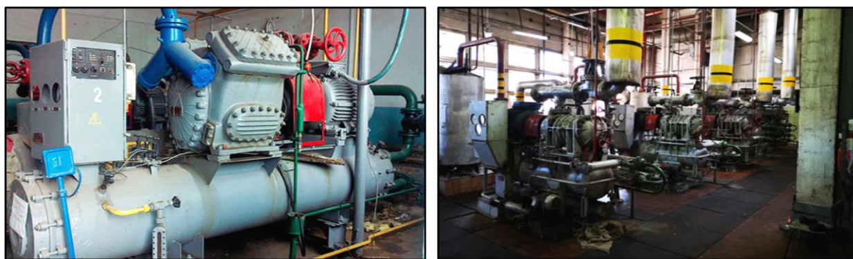
Рис. 2.13. Компресори холодильних установок з холодоагентом
