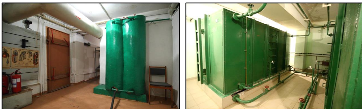
Рис. 20.8. Баки з технічною водою
