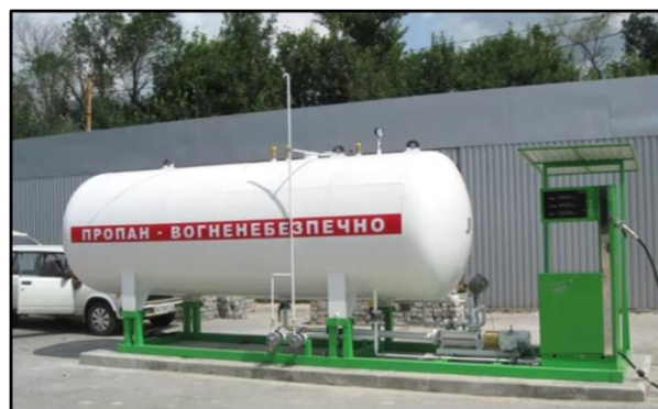
Рис. 22.2. Автомобільний газозаправний пункт
