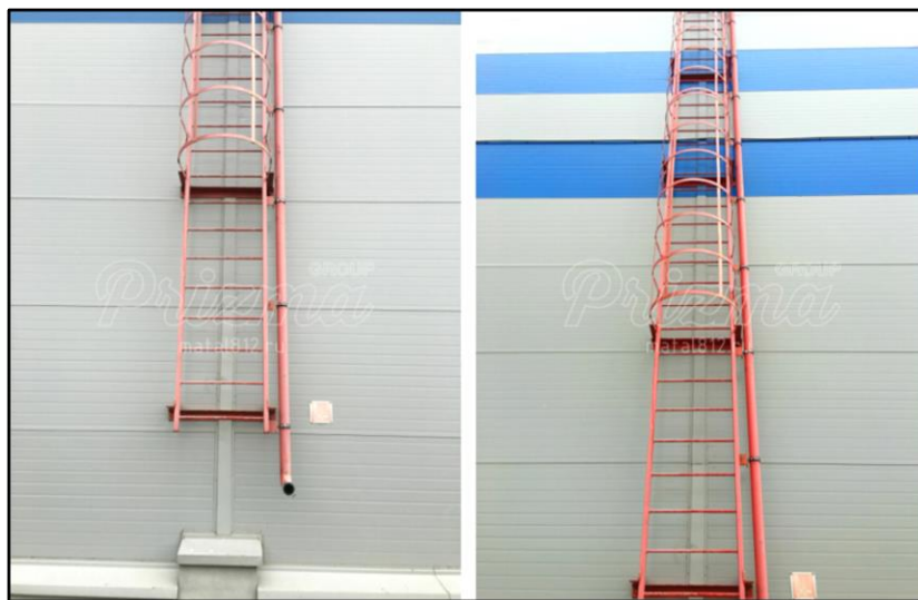
Рис. 7.1. Зовнішні пожежні драбини обладнані стояками сухотрубами діаметрами 80 мм
