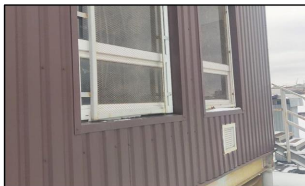
Рис. 22.7. Віконні прорізи котельні з пристроями для попередження можливого розкидання скла
