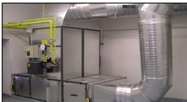
Рис. 21.1. Зовнішній вигляд установки повітряного опалення
