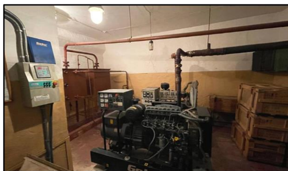
Рис. 20.2. Вигляд захищеної дизельної електростанції
