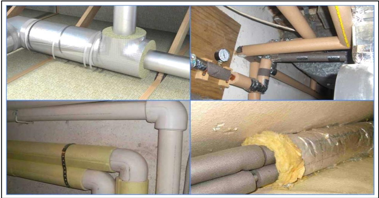
Рис. 2.10. Приклад виконання ізоляція трубопроводів і повітроводів, розміщених у просторі за підвісною стелею
