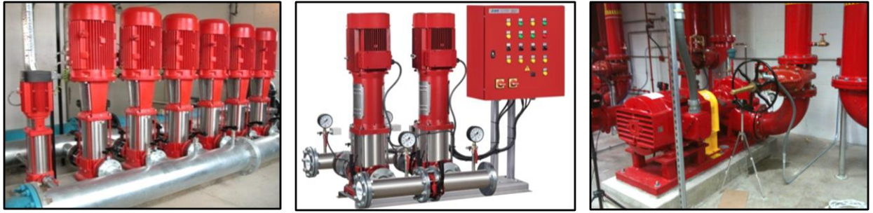
Рис. 7.8. Приміщення станцій пожежогасіння з насосним обладнанням
