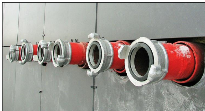
Рис. 9.5. Пожежні патрубка для приєднання рукавів та подачі води від пересувної протипожежної техніки
