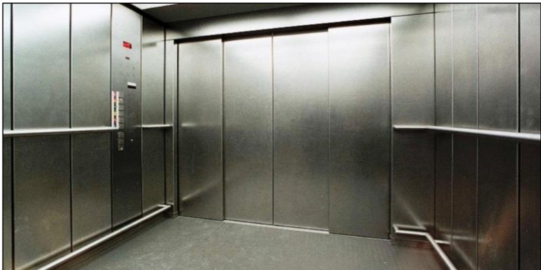
Рис. 6.5. Внутрішній вигляд пожежного ліфта
