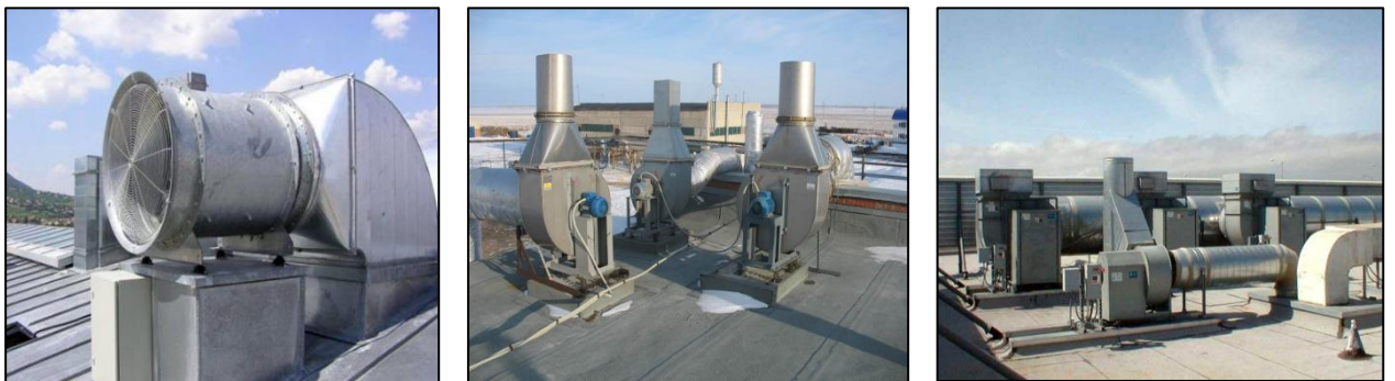
Рис. 3.11. Вентилятори систем механічного димо- та тепловидалення
