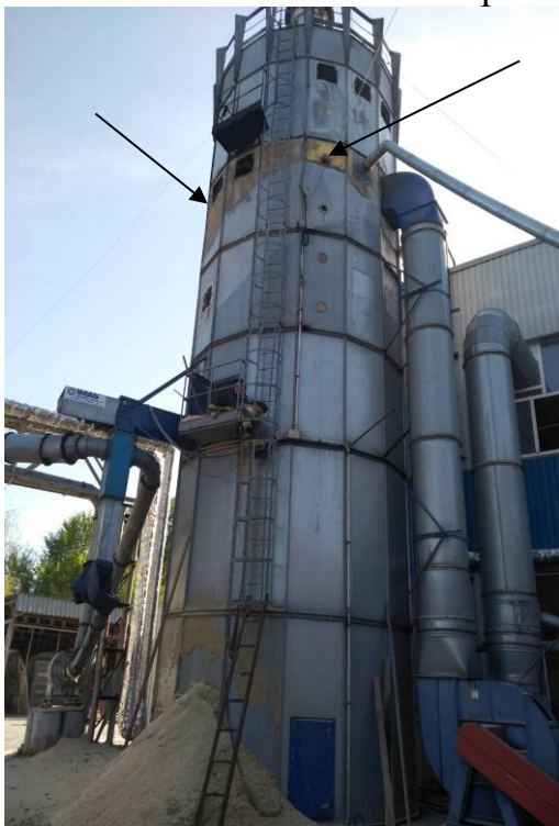
Вигорання фарби з зовнішнього боку металевих конструкцій, горіння відбувалося в об'ємі металевого бункеру
