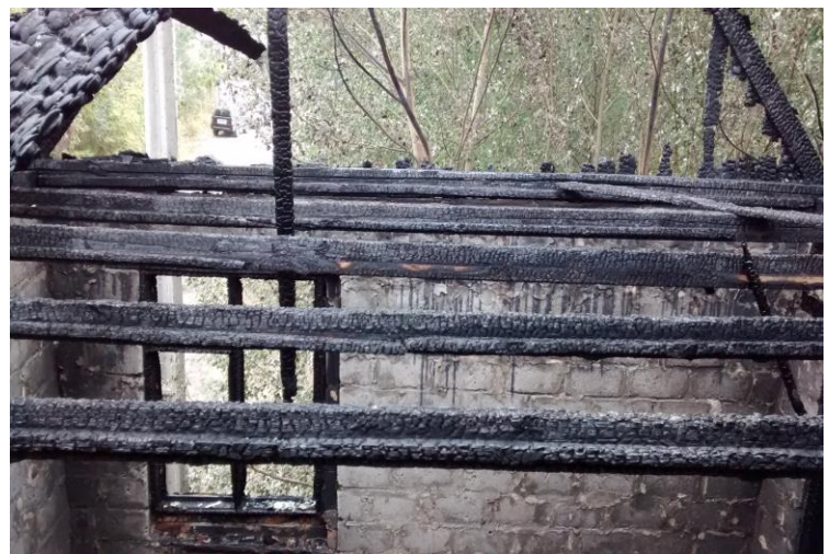
Різний вигляд вугілля на однотипних дерев'яних конструкціях – рихле вугілля з крупними тріщинами на конструкціях, що знаходяться на передньому плані, та щільне вугілля на конструкціях на задньому плані.
