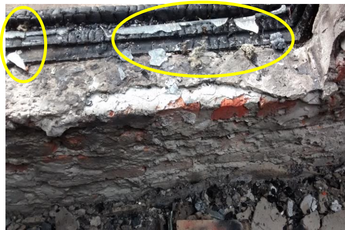
Фрагменти скла зі слідами оплавлення на конструкціях віконного коробу. Зовнішній вигляд уламків скла свідчить, що скло знаходилося у зоні дії температури порядку 700-750°C.
