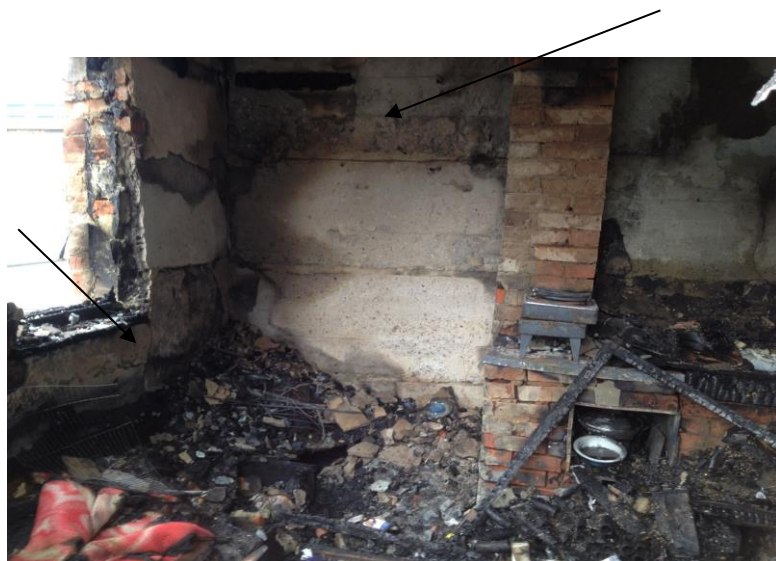
Руйнування захисного шару на залізобетонних конструкціях.
