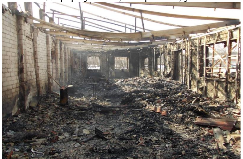
Поступово затухаюча величина деформації однорідних металевих конструкцій (прогин униз) у напрямку від переднього плану фотографії до заднього.
