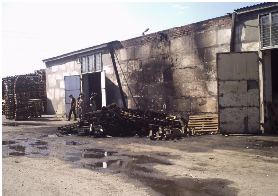
«Осередковий конус», що сформувався на зовнішньому боці стіни будівлі шляхом нашарування кіптяви.
