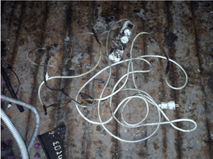
Випадок обвуглення та оплавлення ізоляції з середини – з боку струмопровідних жил.
