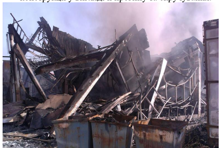
Взаємне розташування обвалених та деформованих конструкцій, вказує, що спочатку обвалення відбулося ближче до центральної частини споруди
