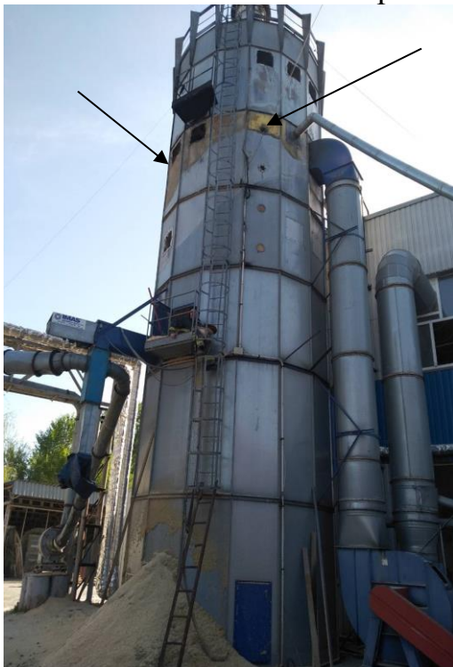
Вигорання фарби з зовнішнього боку металевих конструкцій, горіння відбувалося в об'ємі металевого бункеру
