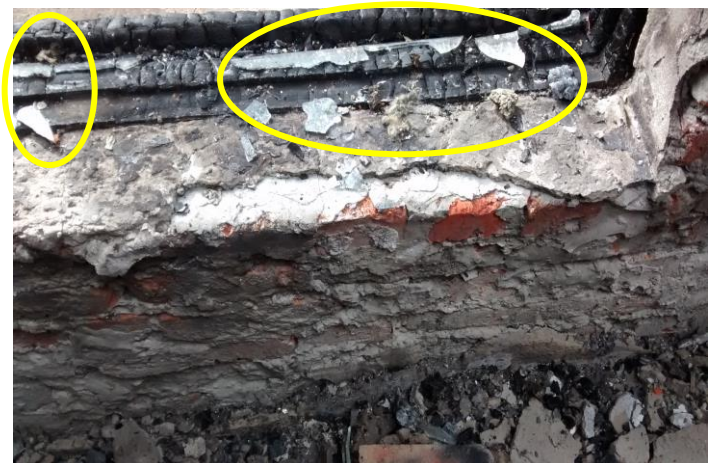
Фрагменти скла зі слідами оплавлення на конструкціях віконного коробу. Зовнішній вигляд уламків скла свідчить, що скло знаходилося у зоні дії температури порядку 700-750°C.
