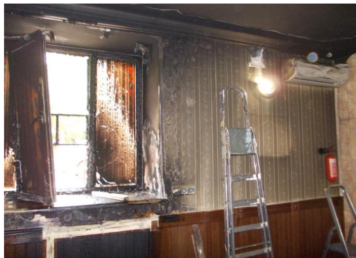
Різні форми ураження конструкцій з полімерних матеріалів – обвуглення елементів віконного блоку та теплова деформація корпусу внутрішнього блоку кондиціонера
