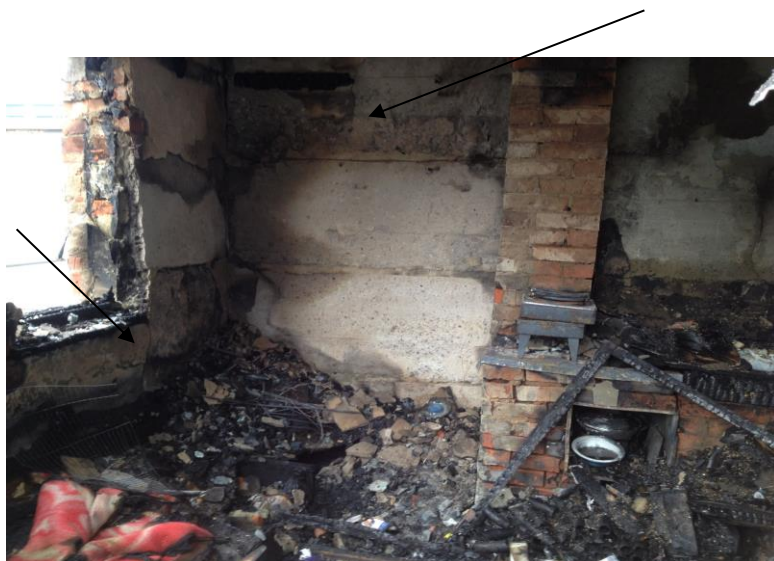
Руйнування захисного шару на залізобетонних конструкціях.
