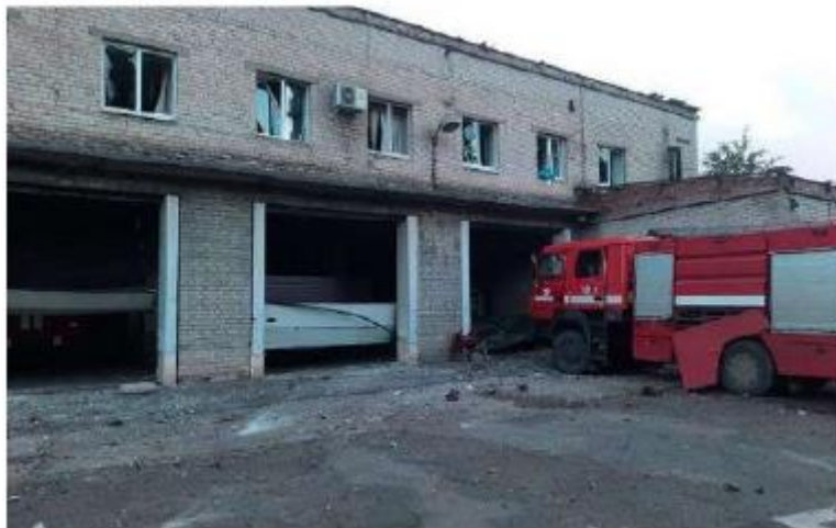
Рис. 3.1. Пошкоджена будівля пожежно-рятувальної частини у місті Костянтинівка Донецької області
