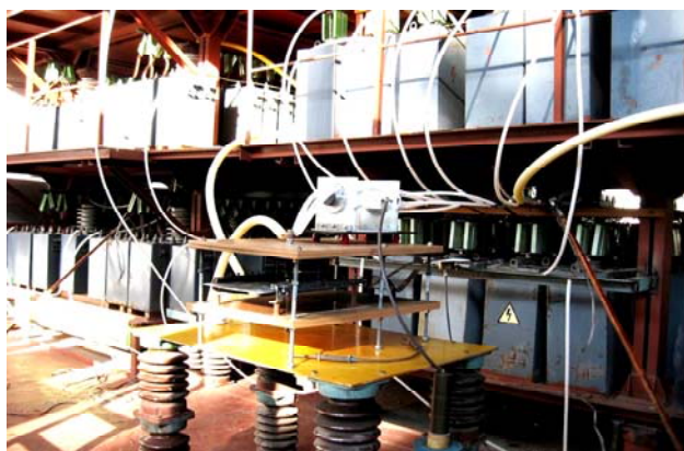
Рис. 1. Общий вид мощного высоковольтного генератора тока имитированной линейной молнии ГИТМ-10/350
