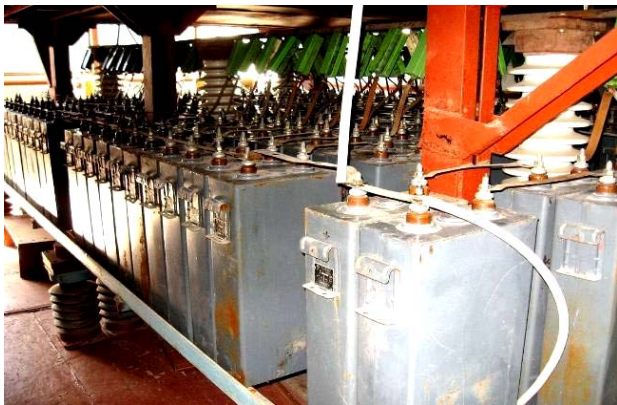
Рис. 5. Общий вид генератора ГИТ-4 (288 последовательно-параллельно включенных конденсаторов типа ИМ2-5-140 на 1 и 2 этажах НМК) на номинальное напряжение \pm 10 кВ, входящего в состав мощного генератора ГИТМ-10/350
