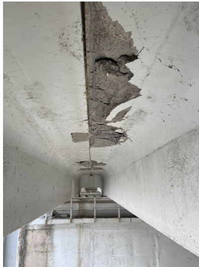
Рис. 2. Руйнування залізобетонних конструкцій балок від удару
