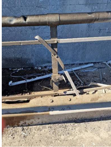
Рис. 4. Руйнування бар'єрного і поручневого огороження
