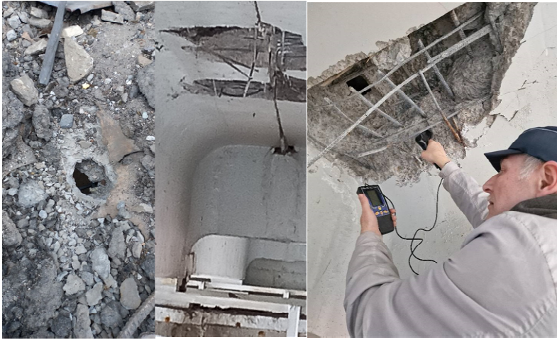
Рис. 1. Типові пошкодження залізобетонних конструкцій та визначення міцності
