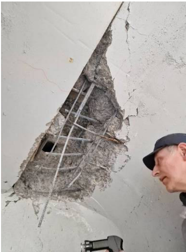
Рис. 1. Характерне пошкодження залізобетонних конструкцій моста в результаті обстрілу
