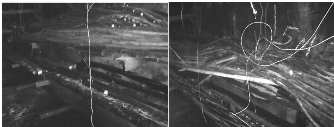
Рисунок 10 – Фото кабелів у тунелі після завершення експерименту.
