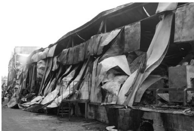
Ryc. 4. Widok zniszczonej hali produkcyjno-magazynowej [2] Fig. 4. View of the destroyed production and storage hall [2]
