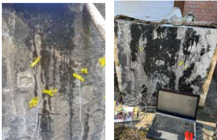
Рисунок 3.16. Фрагмент несучої залізобетонної стіни після виконаного експерименту
