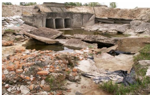
б) вид на автоматический водосброс
