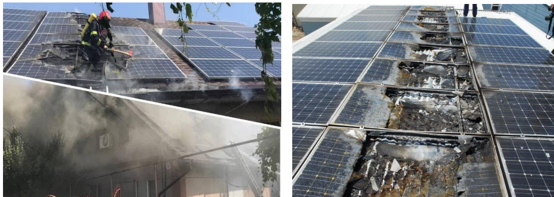
Рисунок 1 – Пожежі фотоелектричних модулів на дахах будинків
