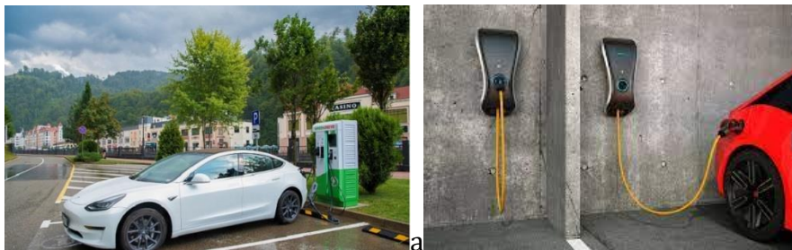
Рисунок 1 – Зображення електрозарядного пункту (а), машиномісця із зарядною станцією для електромобілів (б)
