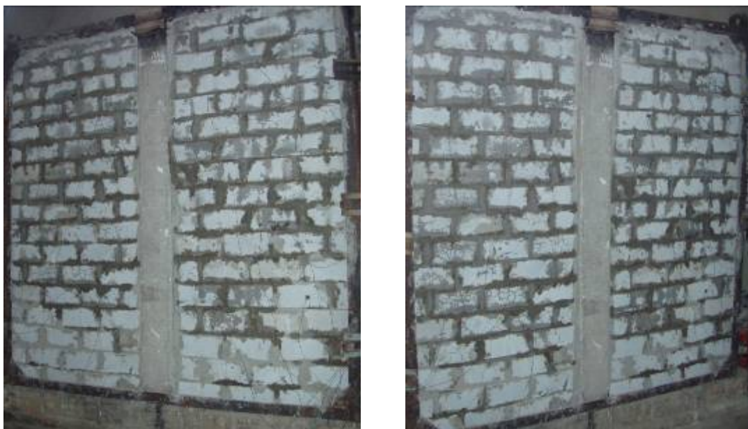
Рис. 4.15. Вигляд стінових фрагментів-зразків №1 та №2 з блоків із легкого бетону після проведення вогневих випробувань.
