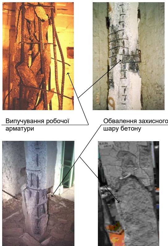
Рис. 1.10. Ознаки втрати несучої здатності залізобетонних колон унаслідок дії пожежі.
