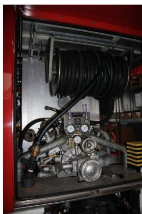
Рисунок 1 – Вигляд насосної установки та спеціального обладнання для подавання тонкорозпиленого струменя води на гасіння пожежі
