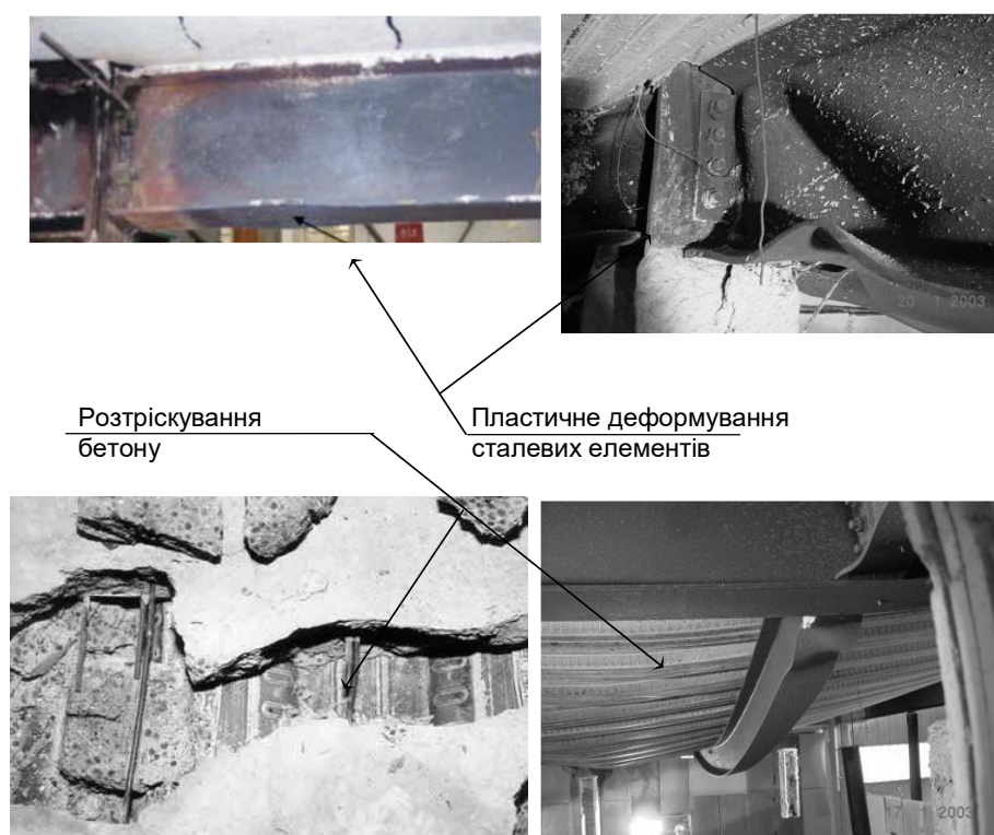
Рис. 1.3. Ознаки втрати несучої здатності залізобетонних ригелів унаслідок дії високих температур.
