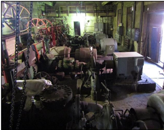
Рис. 2. Насосна станція мартенівського цеху
