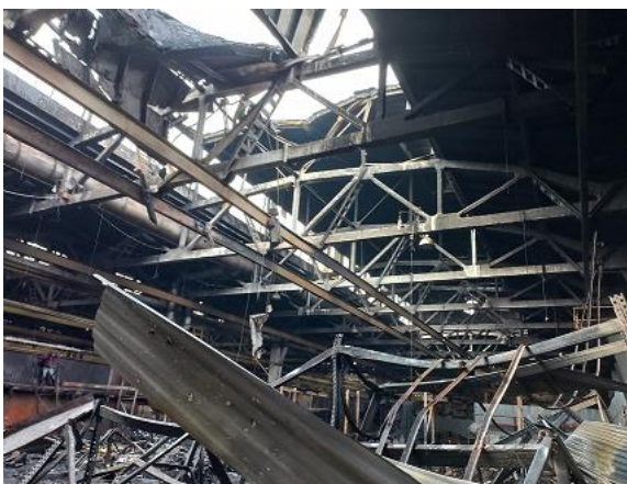
Рис. 1. Багатопролітна одноповерхова будівля, обрушення конструкції світлового ліхтаря.
