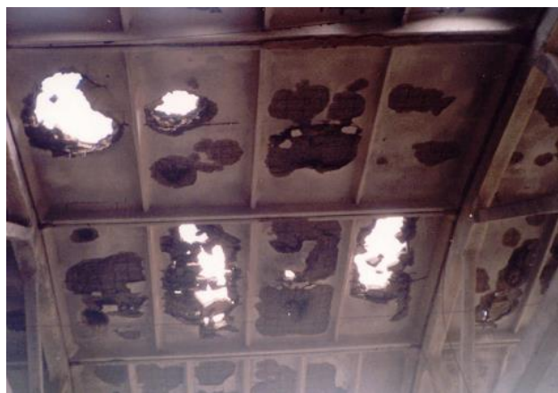
Рис. 2. Багатопролітна одноповерхова будівля, відколювання бетону.
