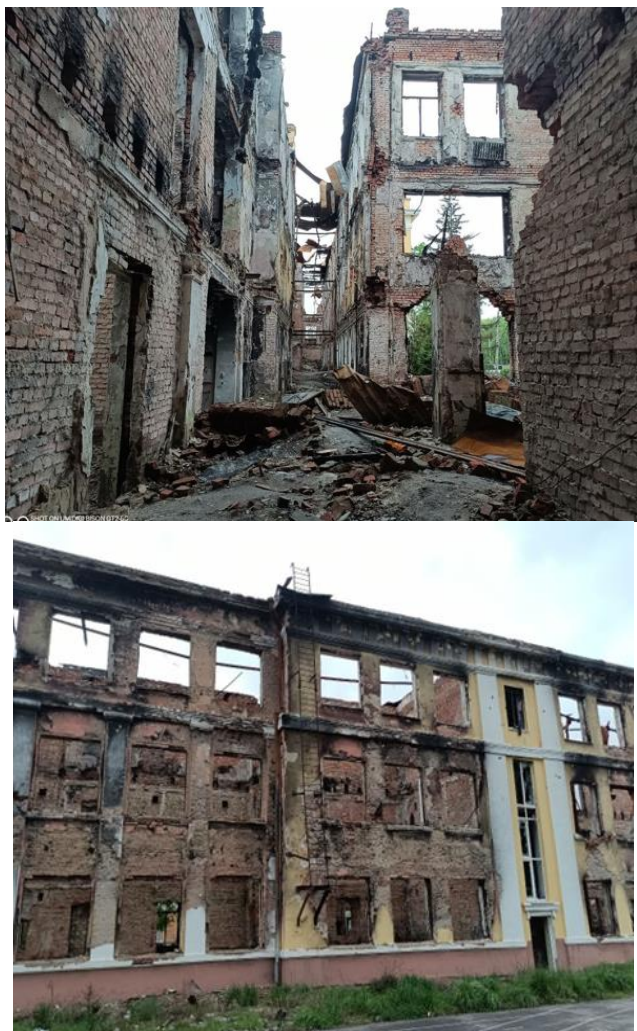
Рис. 2. Руйнування скління, рам, перекриття, конструкцій покриття, зовнішнього опорядження 3-х поверхового блоку
