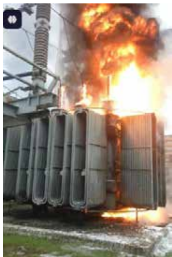
Рис. 1. Приклад пожежі на маслонаповненому силовому трансформаторі
