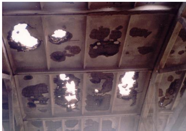
Рис. 2. Багатопролітна одноповерхова будівля, відколювання бетону.
