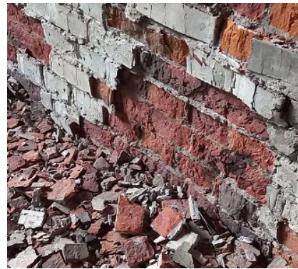
Рис. 4. Двопролітна одноповерхова будівля, відколювання цегли.
