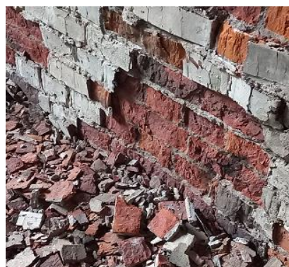
Рис. 4. Двопролітна одноповерхова будівля, відколювання цегли.
