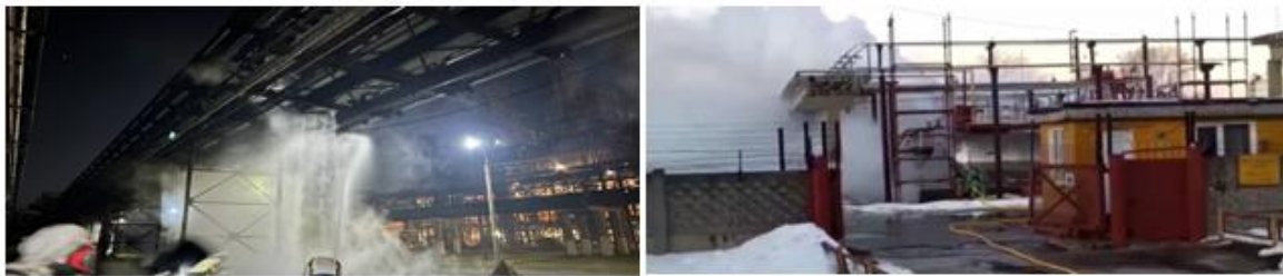
Рис. 1. Пошкодження трубопроводів з НХР
