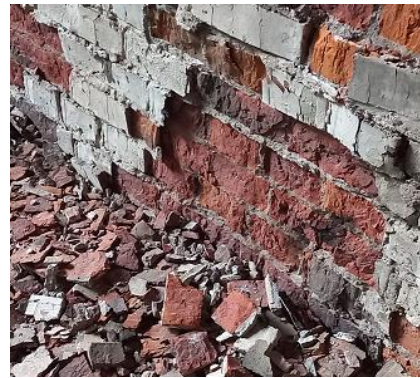
Рис. 4. Двопролітна одноповерхова будівля, відколювання цегли.
