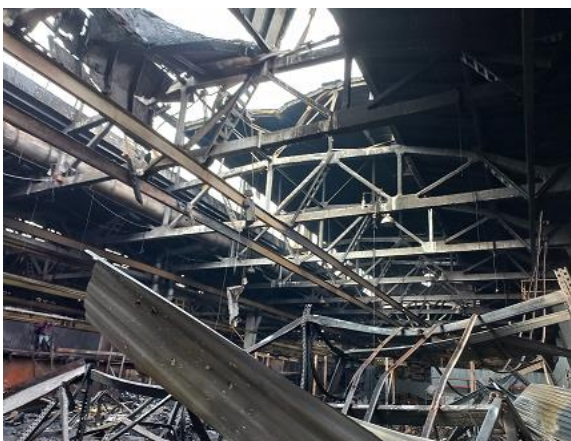
Рис. 1. Багатопролітна одноповерхова будівля, обрушення конструкції світлового ліхтаря.
