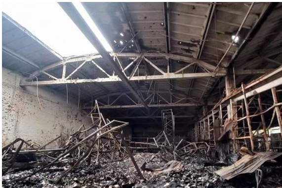
Рис. 3. Двопролітна одноповерхова будівля, руйнування конструкції покриття внаслідок ураження БПЛА.
