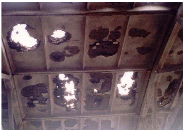
Рис. 2. Багатопролітна одноповерхова будівля, відколювання бетону.
