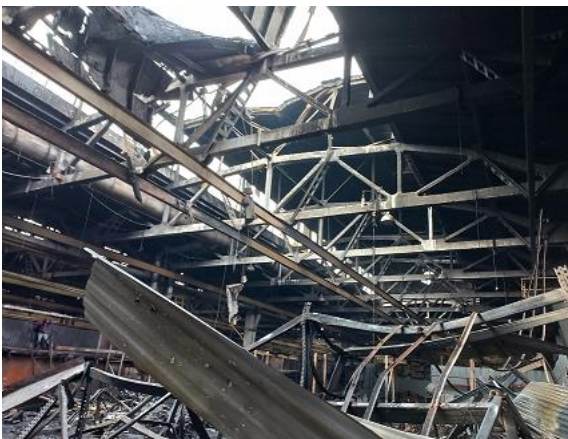
Рис. 1. Багатопролітна одноповерхова будівля, обрушення конструкції світлового ліхтаря.
