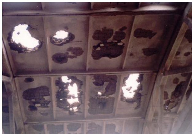
Рис. 2. Багатопролітна одноповерхова будівля, відколювання бетону.
