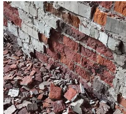
Рис. 4. Двопролітна одноповерхова будівля, відколювання цегли.
