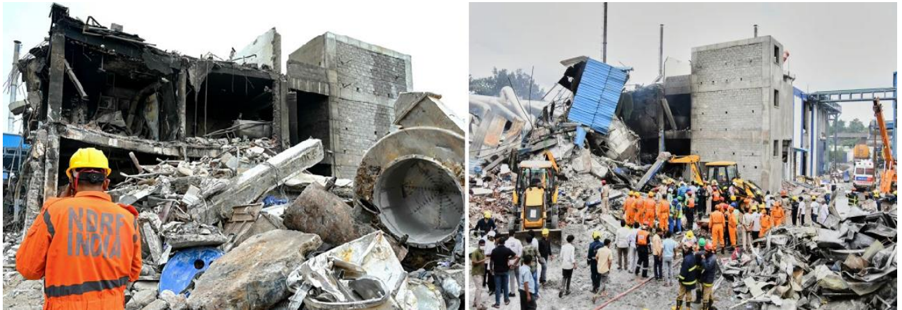
Рисунок 1.10 – Руйнування виробничої будівлі внаслідок вибуху та пожежі
