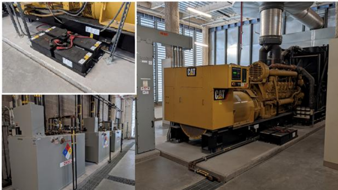
Рис. 1. Вбудована дизельна електростанція та її основні компоненти
