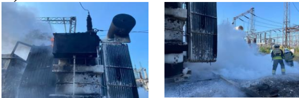
Рисунок 2 – Пожежа трансформатору в м. Миколаївка Краматорського району Луганської області.
