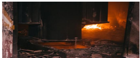
Рисунок 3 – Пожежа трансформатору в Оболонському районі м. Києві
