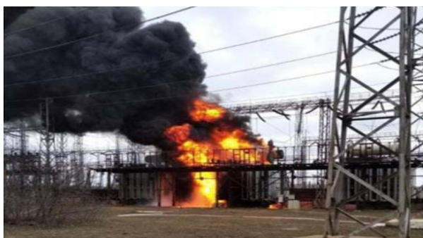
Рисунок 4 – Пожежа трансформатору в с. Кубей Болградського району Одеської області загорівся трансформатор на території електростанції
