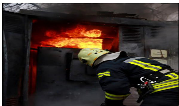
Рисунок 5 – Пожежа трансформатору в м. Луцьк
