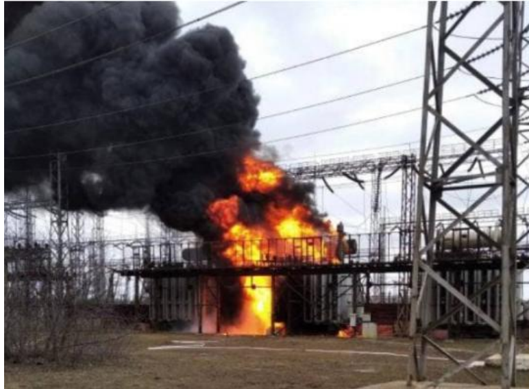
Рисунок 1.3 – Пожежа трансформатору в с. Кубей Болградського району Одеської області загорівся трансформатор на території електропідстанції
