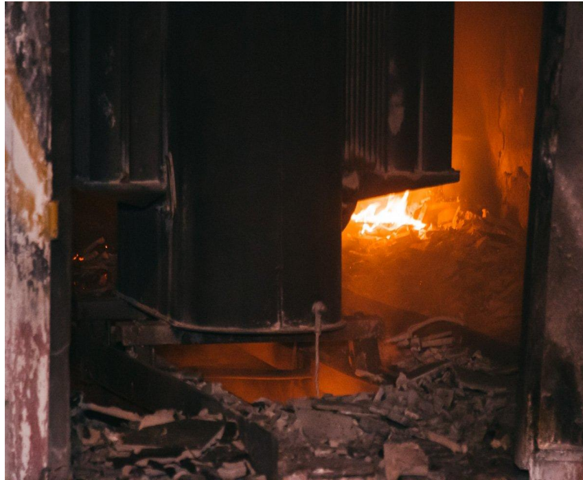
Рисунок 1.2 – Пожежа трансформатору в Оболонському районі м. Києві
