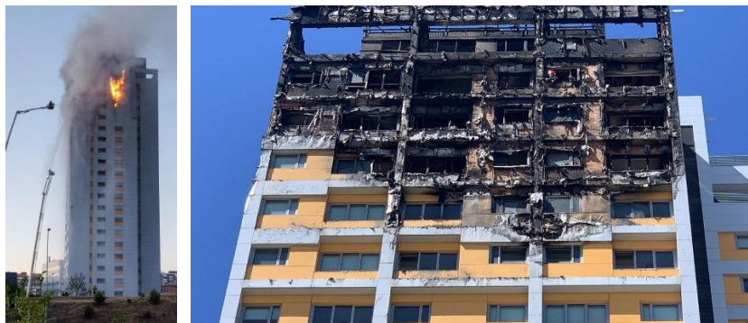
Рисунок 1.3 – Приклад наслідків фасадної пожежі (Іспанія).
