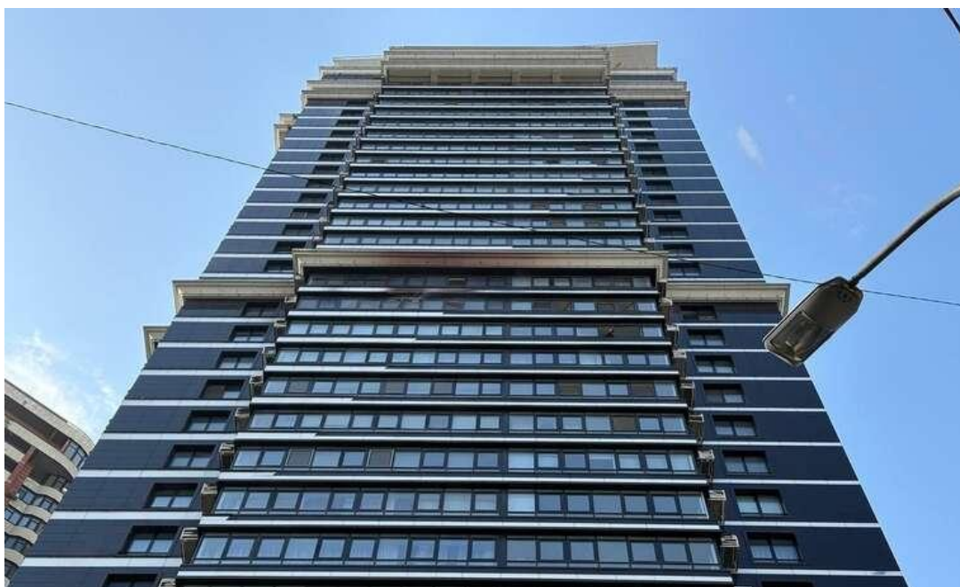
Рисунок 1.8 – Фото будівлі після ліквідації пожежі.
