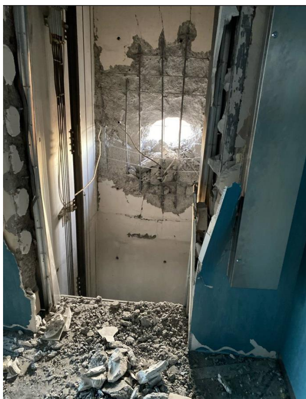
Рисунок 1 – Руйнування залізобетонної стіни ліфтової шахти внаслідок влучання БпЛА з виникненням отвору і оголенням арматури (вигляд з боку приміщень будинку на четвертому поверсі)
