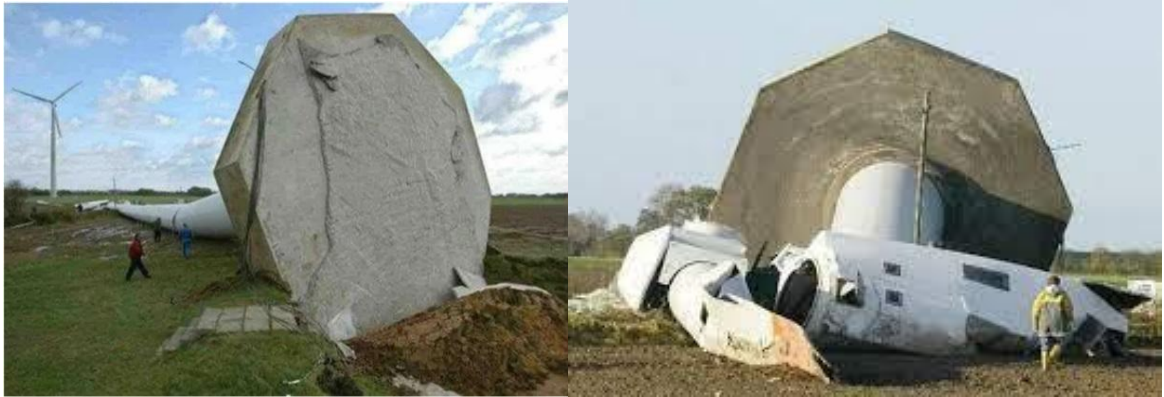
Рисунок 1.8 – Приклад падіння ВЕУ через руйнування несучої опори в 2019 (США).
