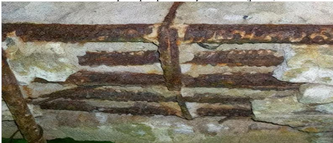
Рис. 1. Корозійні ушкодження арматури в залізобетоні
