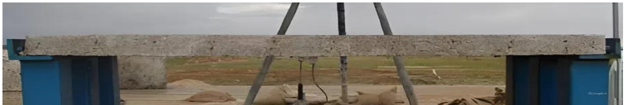
Рисунок 5 – Вигляд залізобетонної плити після випробування [15]
