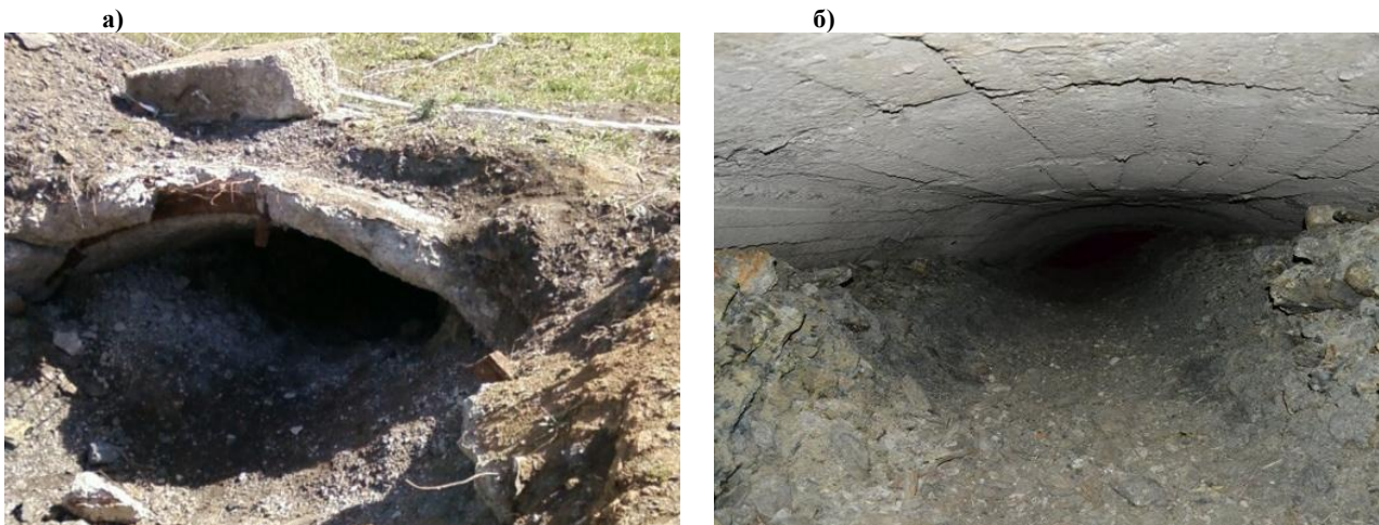
Рис.3. Несанкционированное вскрытие устья наклонного ствола закрытой шахты. а – устье; б – подкровельная пустота
